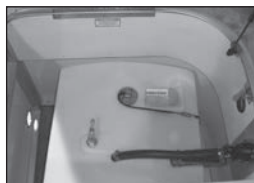
Inspiser ofte slanger og klemmer for drivstofflekkasjer.
